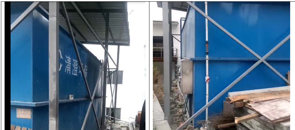
一体化污水处理设施
